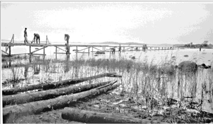
22/33: Brobygge av den första bron till Sumpholmen, ca 1936. Isen tog den efter några år. Denna byggdes av militären och låg öster om nuvarande bro.
