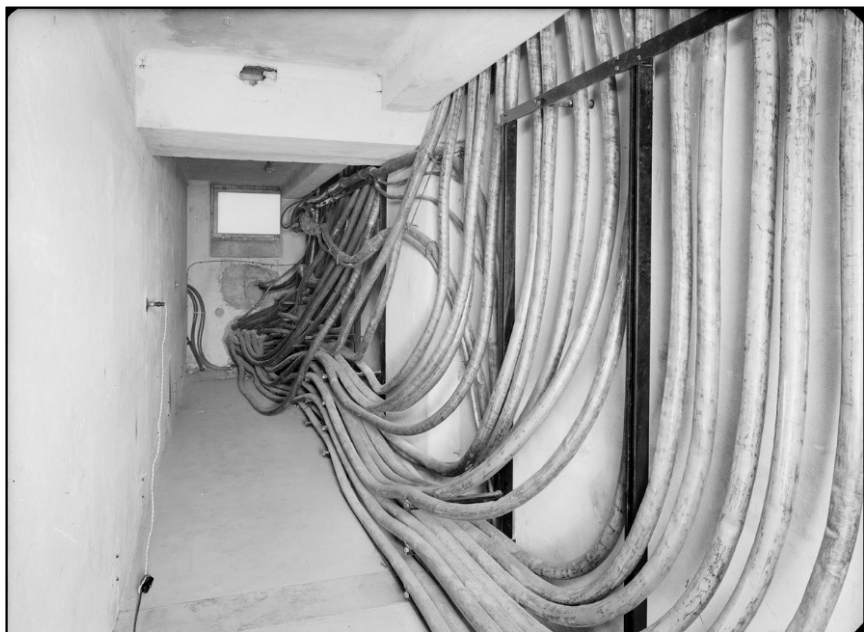
Östermalms manuella rikstelefonstation Karlaplan 2, i Stockholm. Kabelkällaren med blykablär. Okänt år, Tekniska museet.
