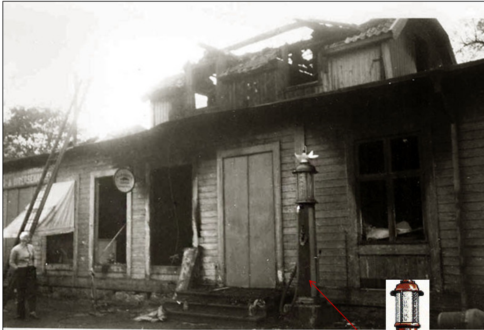
Blomqvist & Hedengrens Speceri-, Delikatess- och Diversehandel efter branden 1950. Odinsvägen 21, Dalarö 2:137. Då förstördes övervåningen som inte återställdes efter branden.
