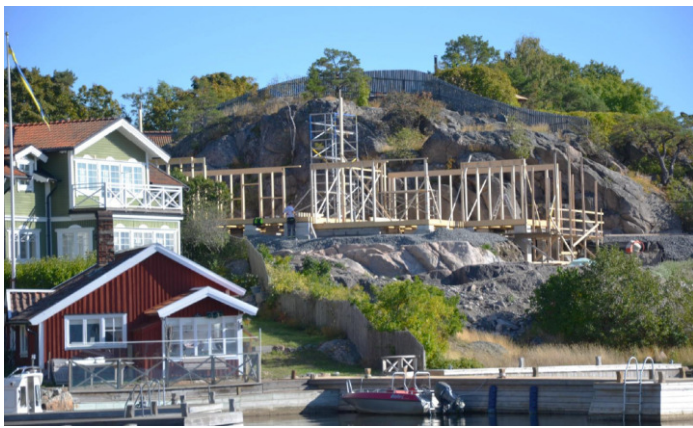
Nytt hus börjar byggas på Skansvägen 6 där det tidigare fanns ett hus. Se DHF:s redovisning SC308 Eklunds udde.
